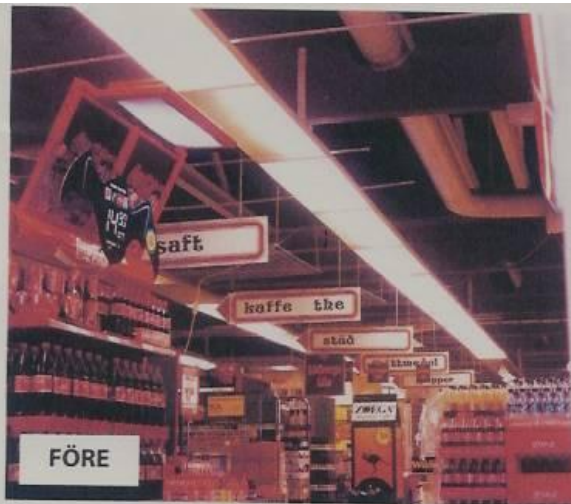
Den tidigare butiksbelysningen från 60-talet bestod av 4 x 36 W armaturlådor i rampmontage för T8 lysrör med bländskydd av prisma-plast.
